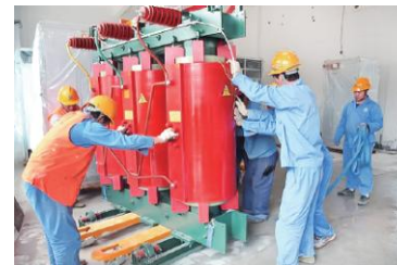
某大型商场地下室供电干式变压器安装
